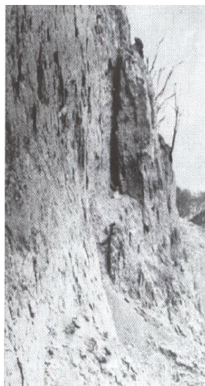
Fig. 10 – Fază activă a prăbușirii falezei.
